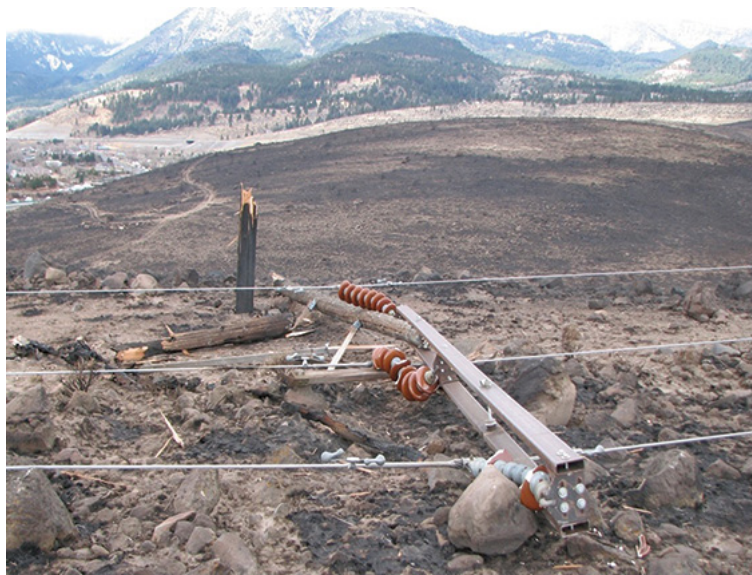
Firestorm damage – ACCC Conductor unharmed
